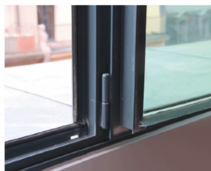
Les châssis d'origine étaient visés dans un précadre et ne disposaient pas de drains satisfaisants.
